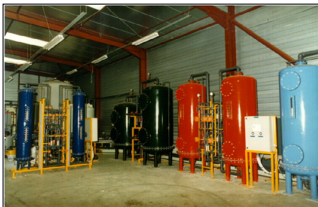
Impianto di demineralizzazione a resine di scambio ionico
